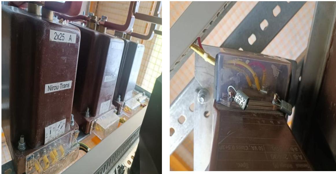
شکل ۱۵: پلمپ CT ها و PT ها در تابلو اندازه گیری ولتاژ اولیه
