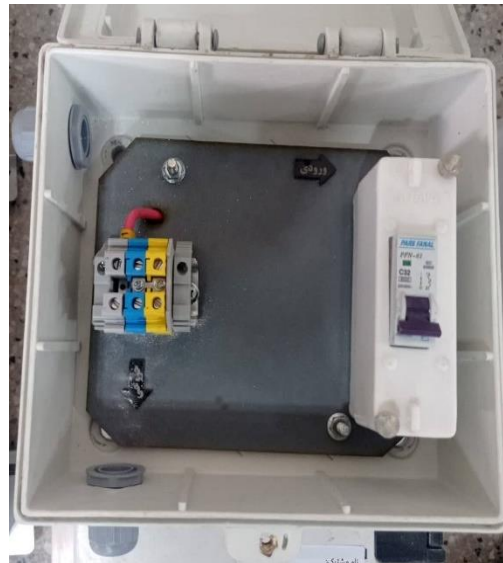
شکل ۵: تابلو مشترک تک فاز جهت نصب در داخل ملک مشترک
