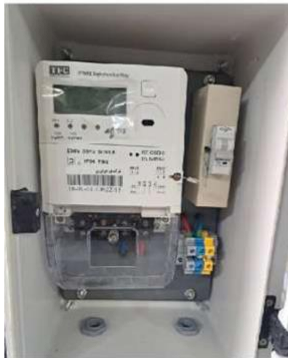
شکل ۱: تابلو کنتور تک فاز فهام ۱ به همراه کلید مینیاتوری مشترک - قابل نصب در ملک متقاضی
