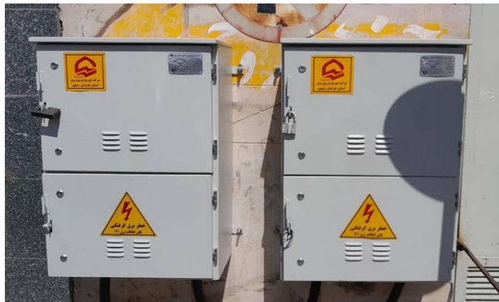
شکل ۱۲: تابلو لوازم اندازه‌گیری اتصال غیرمستقیم زمینی
